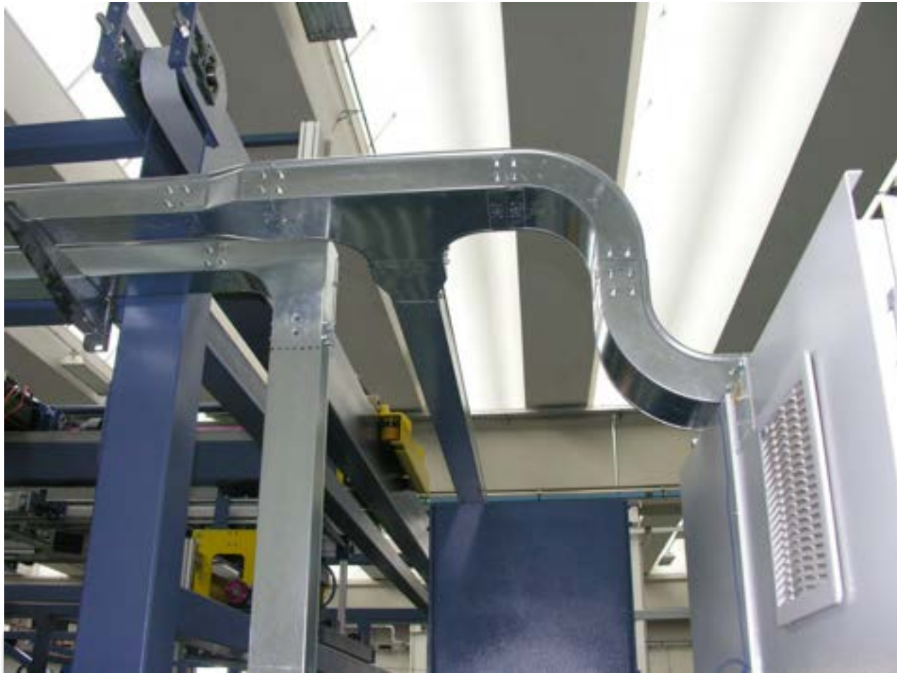
Metal conduits for cables
